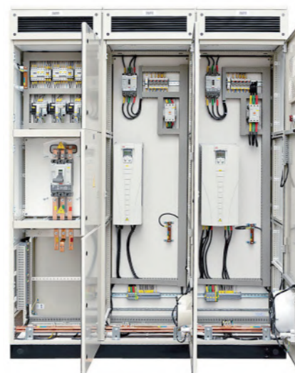
Рис. 20. Пример шкафов со стационарным размещением ПЧ
