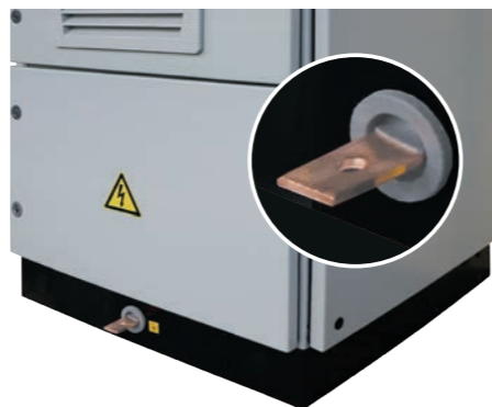
Рис. 39. Вывод шины PE
