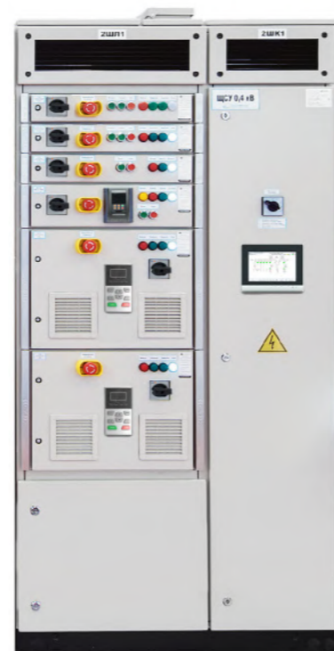
Рис. 28. Пример НКУ, оснащенных системой мониторинга и управления
