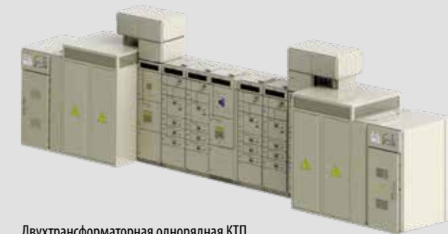
Двухтрансформаторная однорядная КТП
