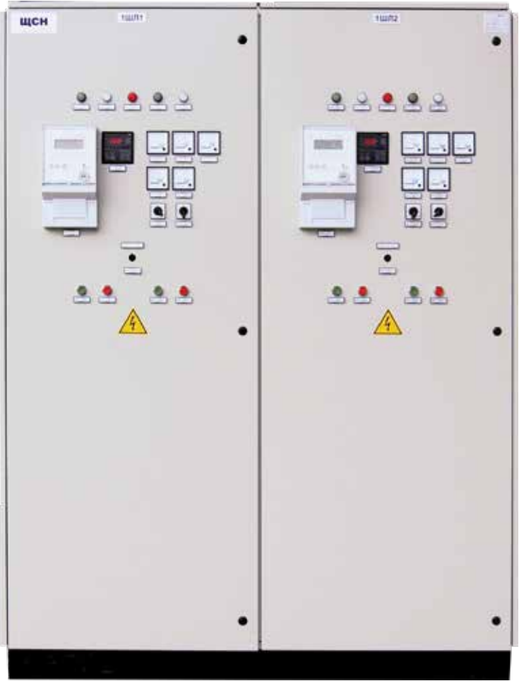
Рис. 17. Щит собственных нужд 0.4 кВ
