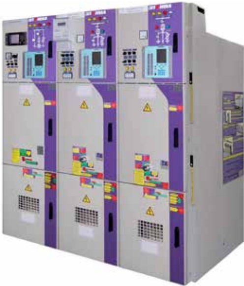
Рис. 8. Комплектное распределительное устройство «Элтимаш» 6-10 кВ
