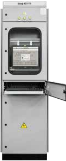
Рис. 23. Шкаф АСУ ТП/ТМ/РАС
