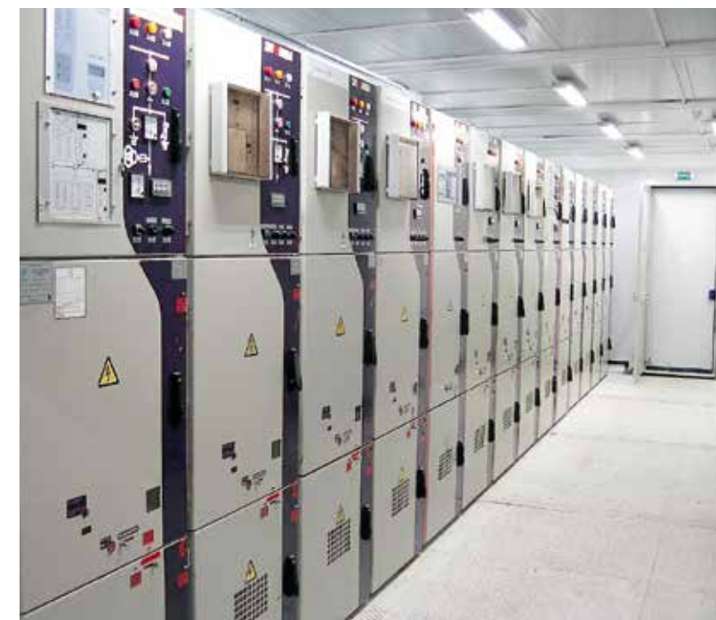
Рис. 41. Закрытое распределительное устройство 10 кВ со шкафами КРУ «Элтима»
