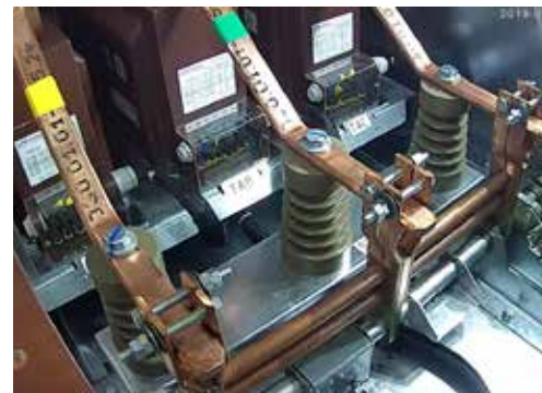
Рис. 31. Вид на заземлитель
