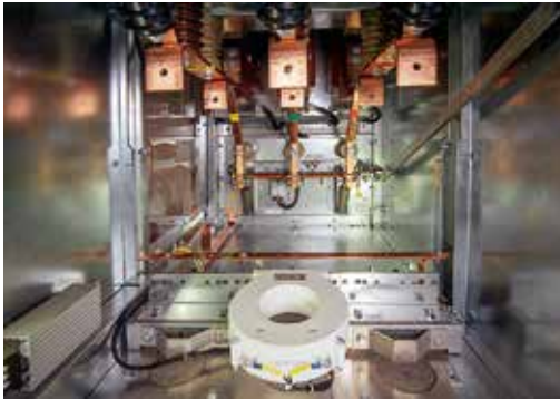
Рис. 22. Отсек присоединений с открытой дверью
