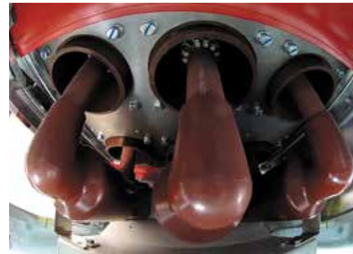
Рис. 30. Вид на контакты силового выключателя
