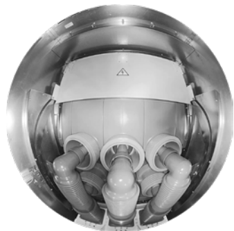
Рис. 17. Вид на контакты силового выключателя
