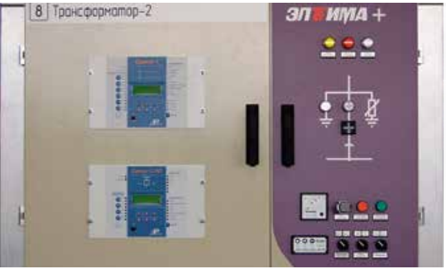
Рис. 15. Фасадная дверь отсека вспомогательных цепей
