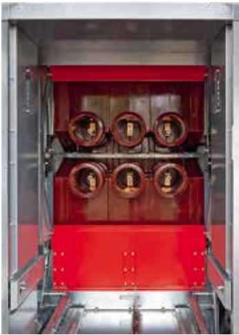
Рис. 8. Шторочный механизм в отсеке ВЭ
