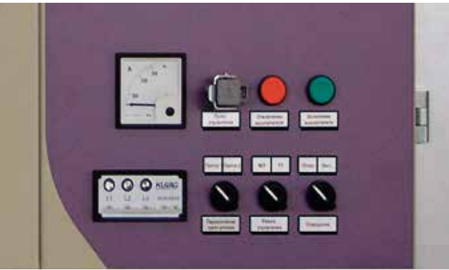
Рис. 14. Индикатор наличия напряжения в составе шкафа КРУ «Элтима+»
