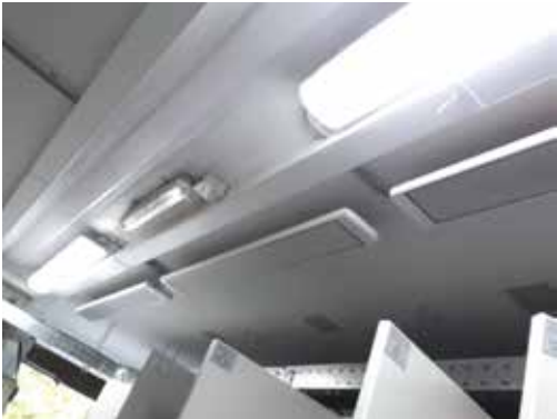
Рис. 6. Внутреннее оснащение БКТП-ELM
