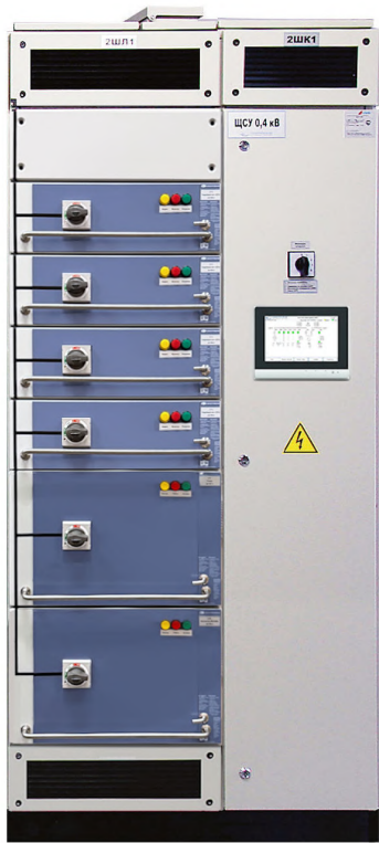
Рис. 24. Пример НКУ, оснащенных системой мониторинга и управления
