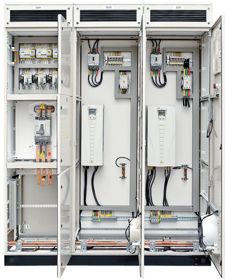
Рис. 17. Пример шкафов со стационарным размещением ПЧ
